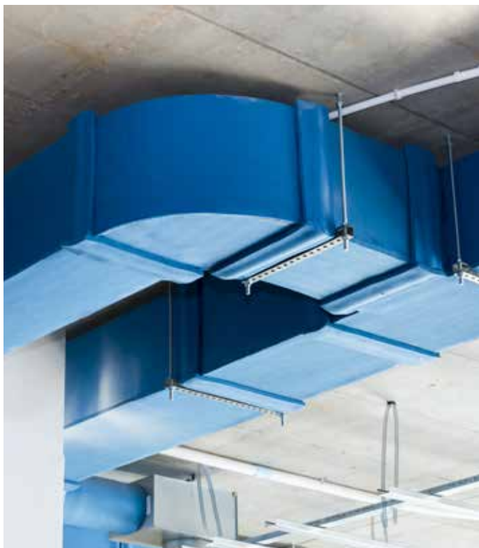
Kanały wentylacyjne zostały zaizolowane przy użyciu nowej elastomerowej izolacji, generującej znacząco mniej dymu w przypadku pożaru niż typowe materiały izolacyjne.
