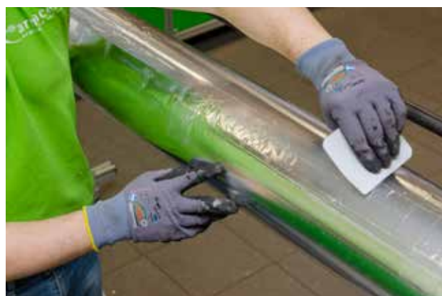
PUR limmas också med ett tvåkomponents bindemedel. Därefter måste man sätta på aluminiumtejp på alla längsgående och runtgående sömmar för att få en diffusionstät tillslutning.
