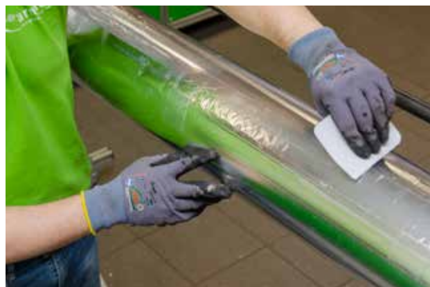
PUR blir også limt ved hjelp av et tokomponent lim. Deretter festet en klebende aluminiumstape på alle skjøter (både langsgående og rundt røret), for å sikre en diffusjonssikker skjøt.
