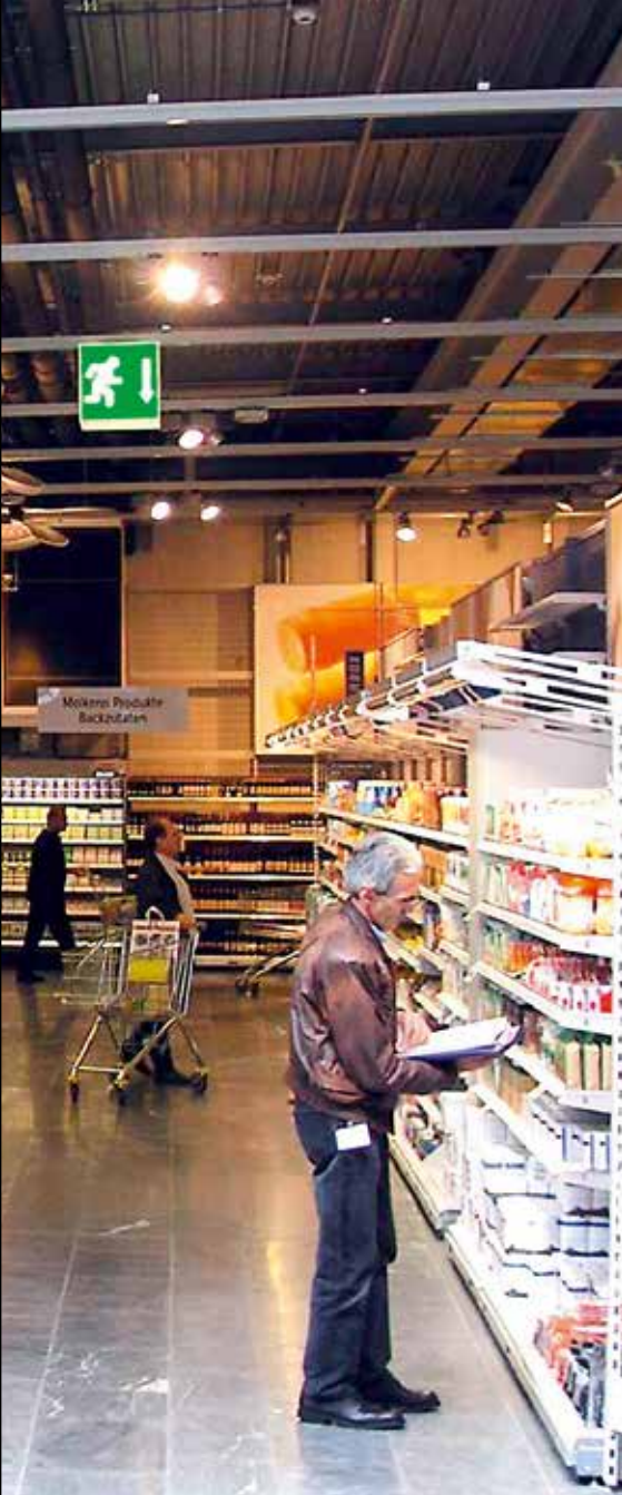
Dit wilt u beslist niet: druppelende condensvorming uit het plafond.
