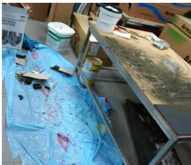
Quand on installe de la PUR et du verre cellulaire, une grande quantité de poussière est générée et la zone de travail doit toujours être recouverte d'une bâche.
