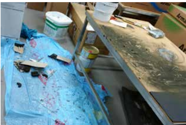
PUR-eristeitä ja vaahtolasia asennettaessa syntyy huomattavan paljon pölyä ja työskentelyalue on aina peitettävä pressulla.
