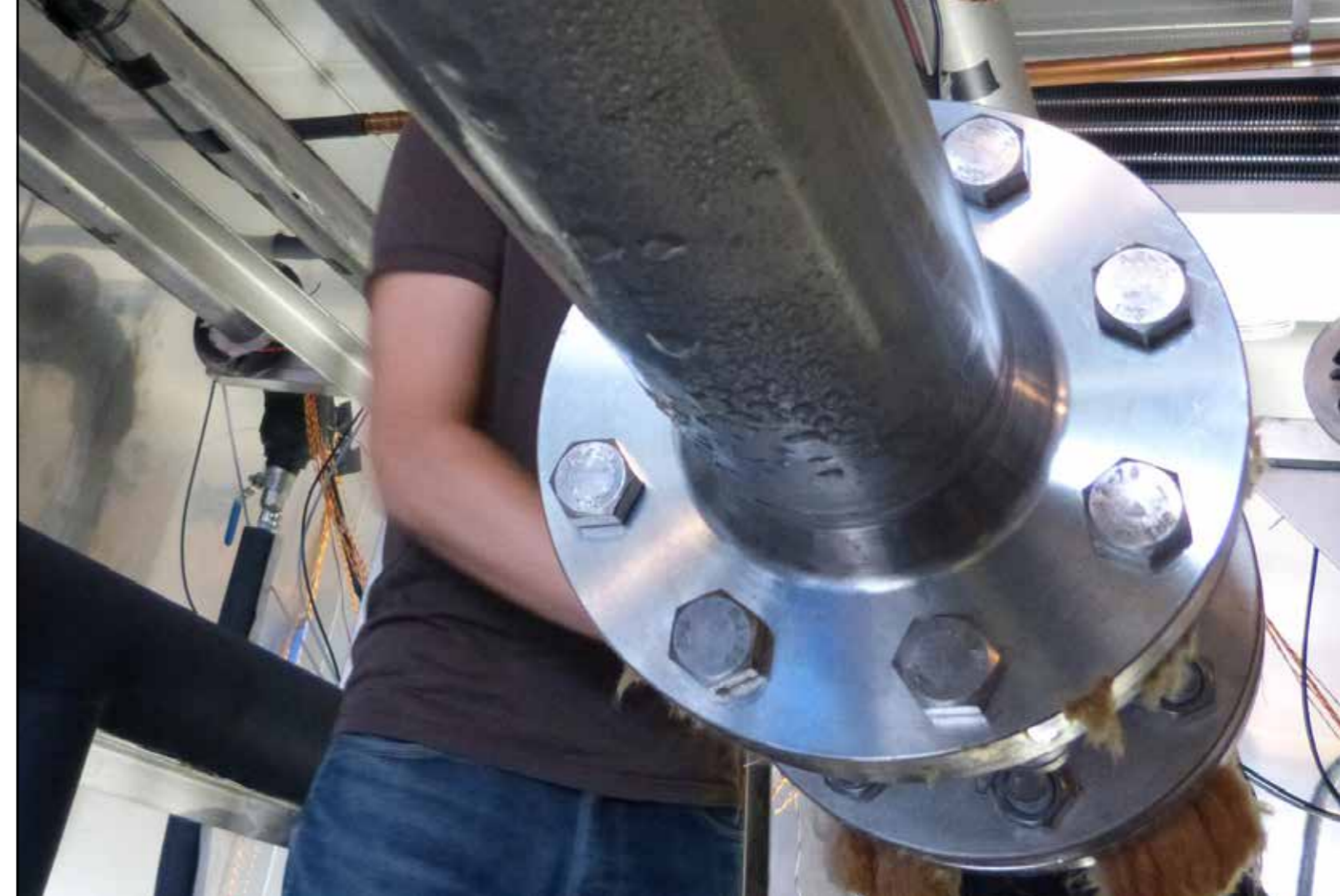
Abbildung 6: Währen bei der Mineralfaserdämmung gerade im Bereich von Armaturen feuchte Luft eingedrungen ist, sind unter der FEF-Dämmung auch diese Bereiche trocken geblieben
