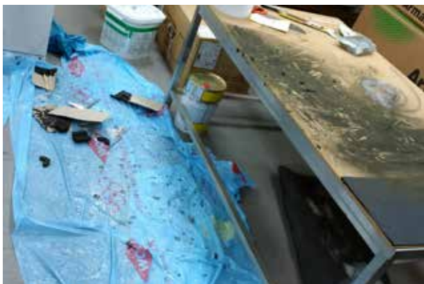
Bei der Verarbeitung von PUR und Schaumglas entstehen erhebliche Mengen an Staub und der Arbeitsplatz sollte unbedingt mit einer Plane geschützt werden
