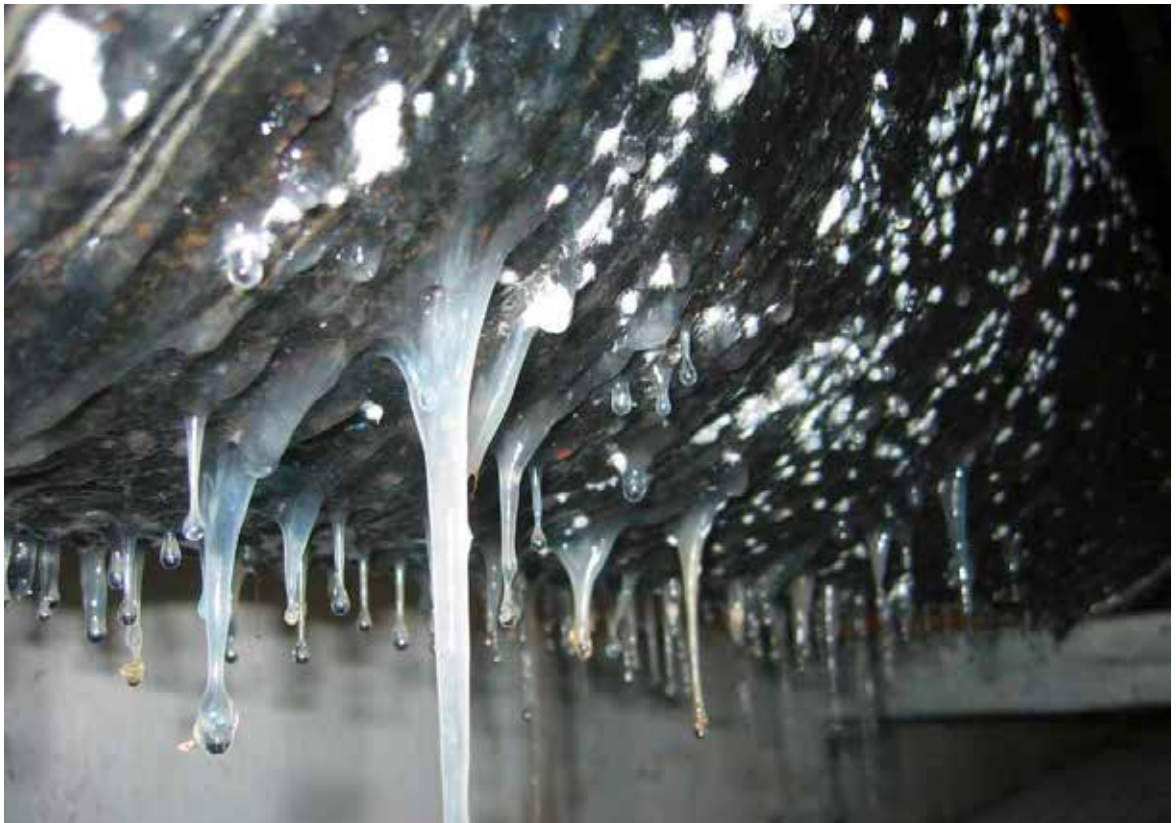
So sollte es nicht aussehen: Dämmungen von Anlagen, die anfänglich einwandfrei funktionieren, aber nach einiger Betriebszeit Tauwasser- oder wie hier: sogar Eisbildung zeigen
