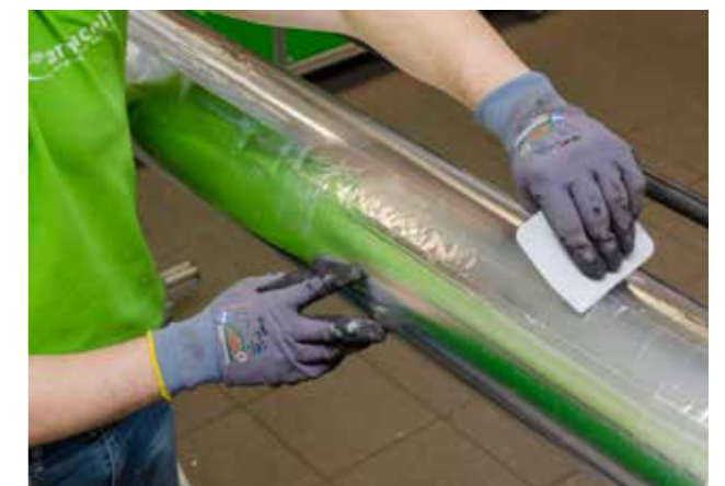
Auch PUR wird mit einem Zweikomponenten-Kleber verarbeitet. Anschließend müssen sämtliche Längs- und Rundnähte mit Aluklebeband diffusionsdicht verklebt werden
