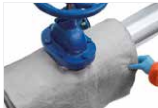
Afbeelding 57: Omwikkel flenzen om de klep te omsluiten en zet vast met draadband.
