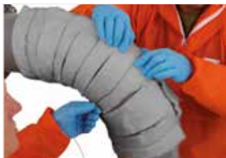
Afbeelding 40: Druk alle sleuven samen om te vermijden dat er openingen of holtes bij de voegen ontstaan.
