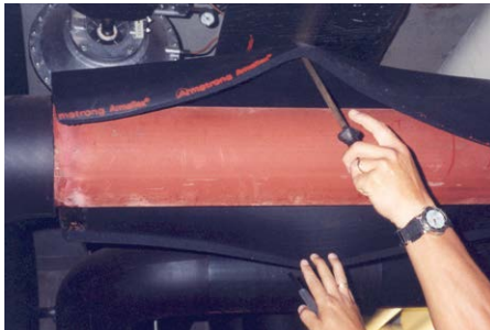
Una de las primeras instalaciones de AF/ArmaFlex sigue en funcionamiento.
